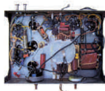
Blick in das «kreuz und quer» verdrahtete Chassis – die Kondensatoren waren grösstenteils defekt, ebenso beide Potentiometer; die Widerstände zeigten Toleranzen von bis zu 50 %, ein Sieb-Elko machte Kurzschluss. Ausserdem war der Lautsprecher völlig dezentriert.
