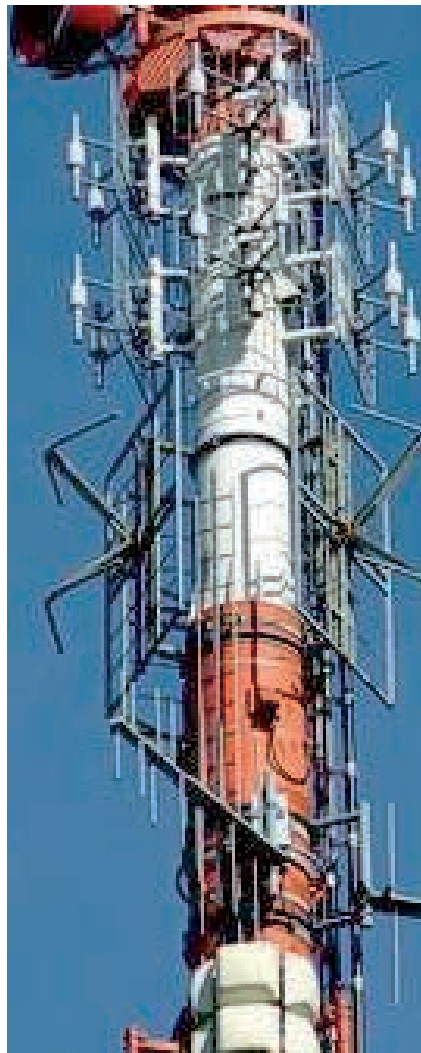
Antennenmast mit DAB-Antennen im obersten Teil
